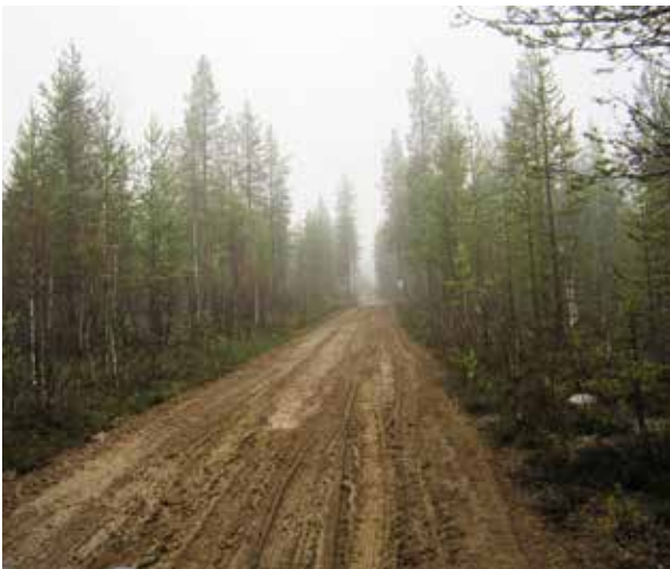
Körskador på väg utan diken.
